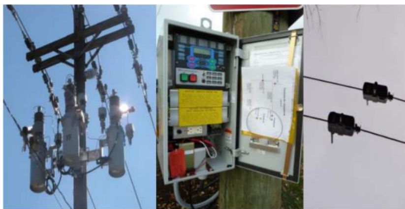
Figura 4-8. Reconectores electrónicos, unidades de control y sensores de línea instalados por Duke Energy
