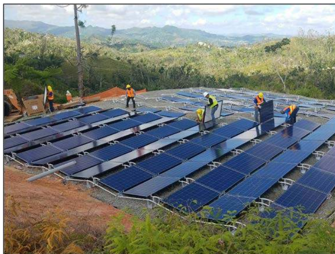
Figura 4-13. Instalación de energía solar
