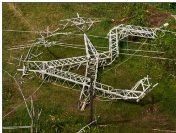
Figura 2-5. Estructura de transmisión derribada por el huracán María
