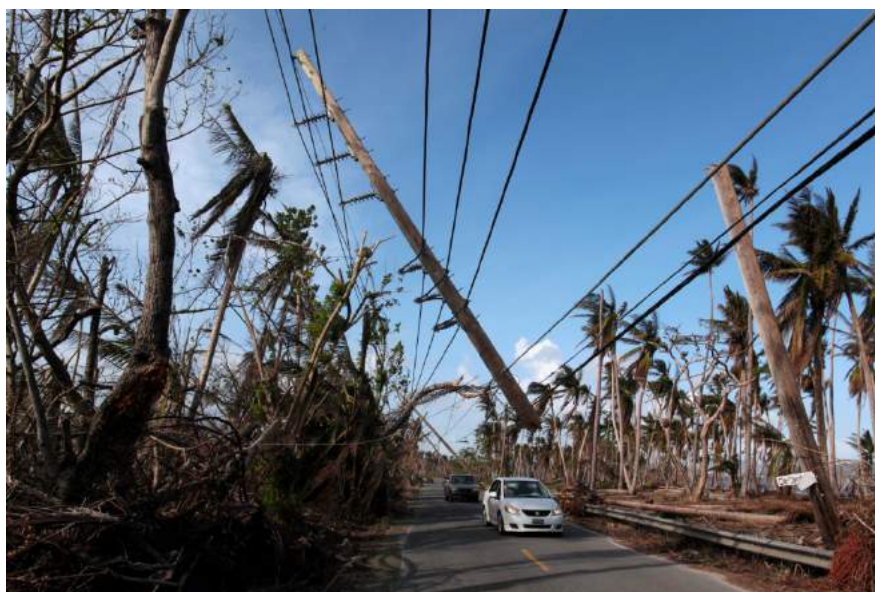
Figura 1. Postes de distribución rotos tras la tormenta
