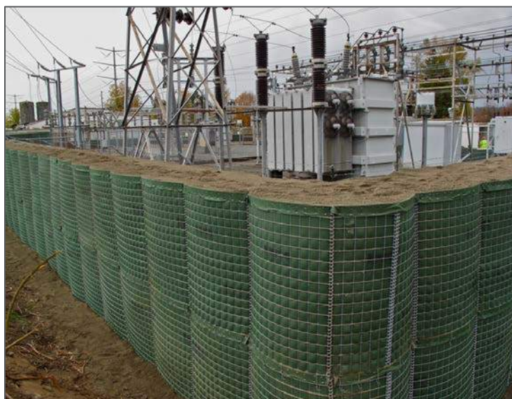
Figura 4-6. Barrera contra inundaciones en subestación
